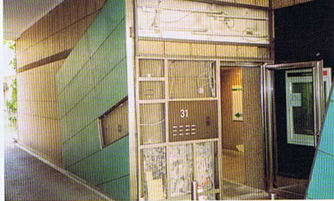
Bild 4.: Die schrägen Fugenbilder der Wandbekleidung mit Tecu-Patina-Tafeln unterstreichen bereits in diesem Frühstadium der Arbeiten die formale Dynamik.
